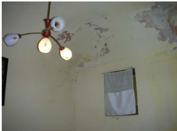
Particolare dello stato degli intonaci
