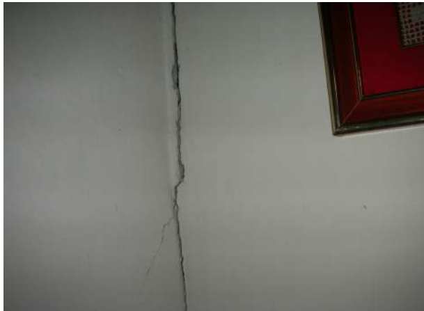
Particolare delle lesioni murarie
