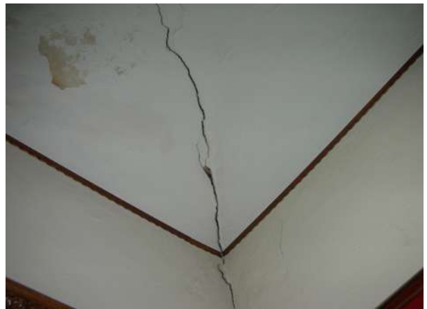
Particolare delle lesioni nelle volte
