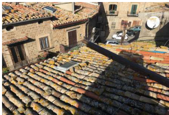
Stato delle coperture viste dall'altana
