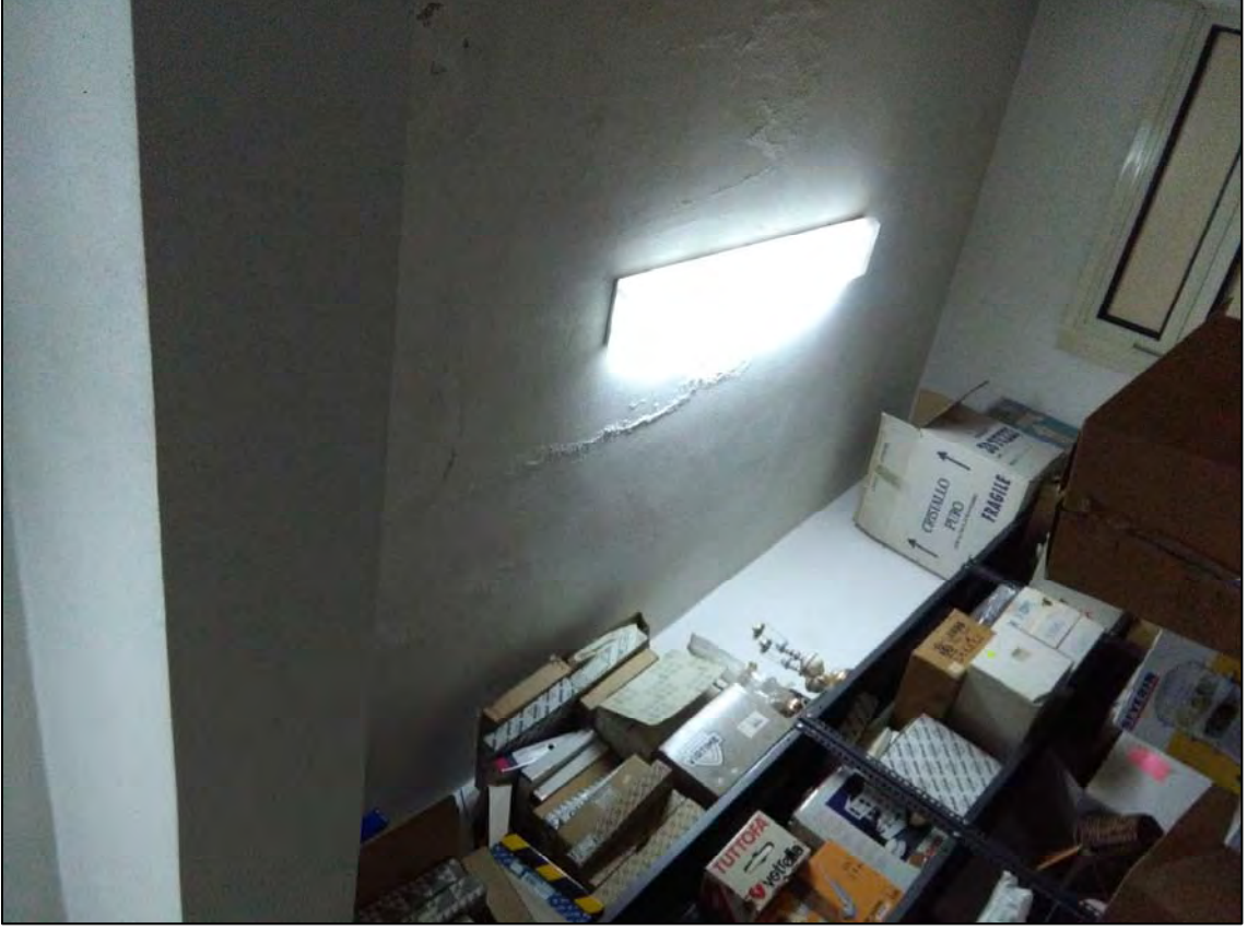
Foto 6 - Deposito - zona con infiltrazione
