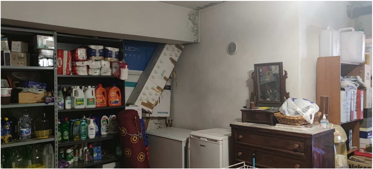
Foto 03 -locale a piano cantinato, della parete soggetta ad infiltrazioni da risalita e dal piano soprastante
