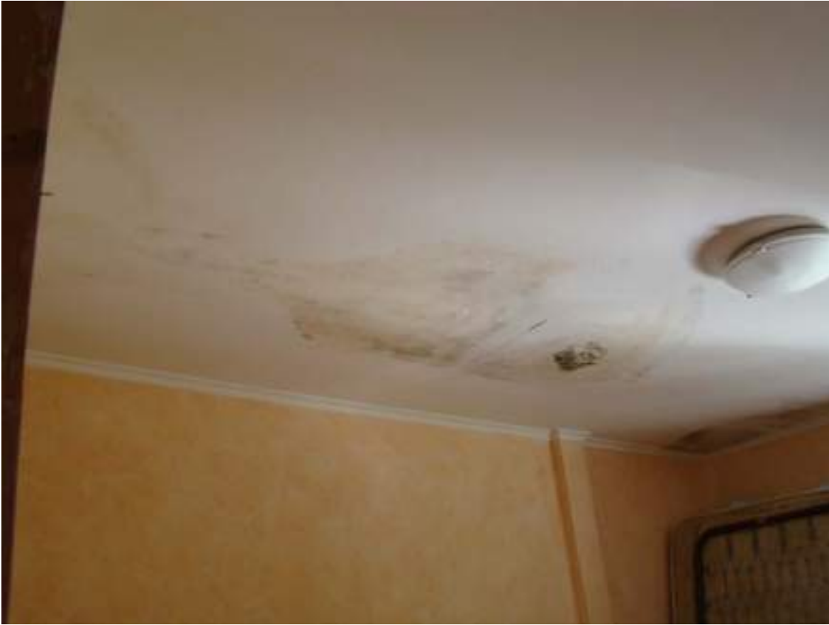
Figura 13 - Muffe su soffitto camera singola
