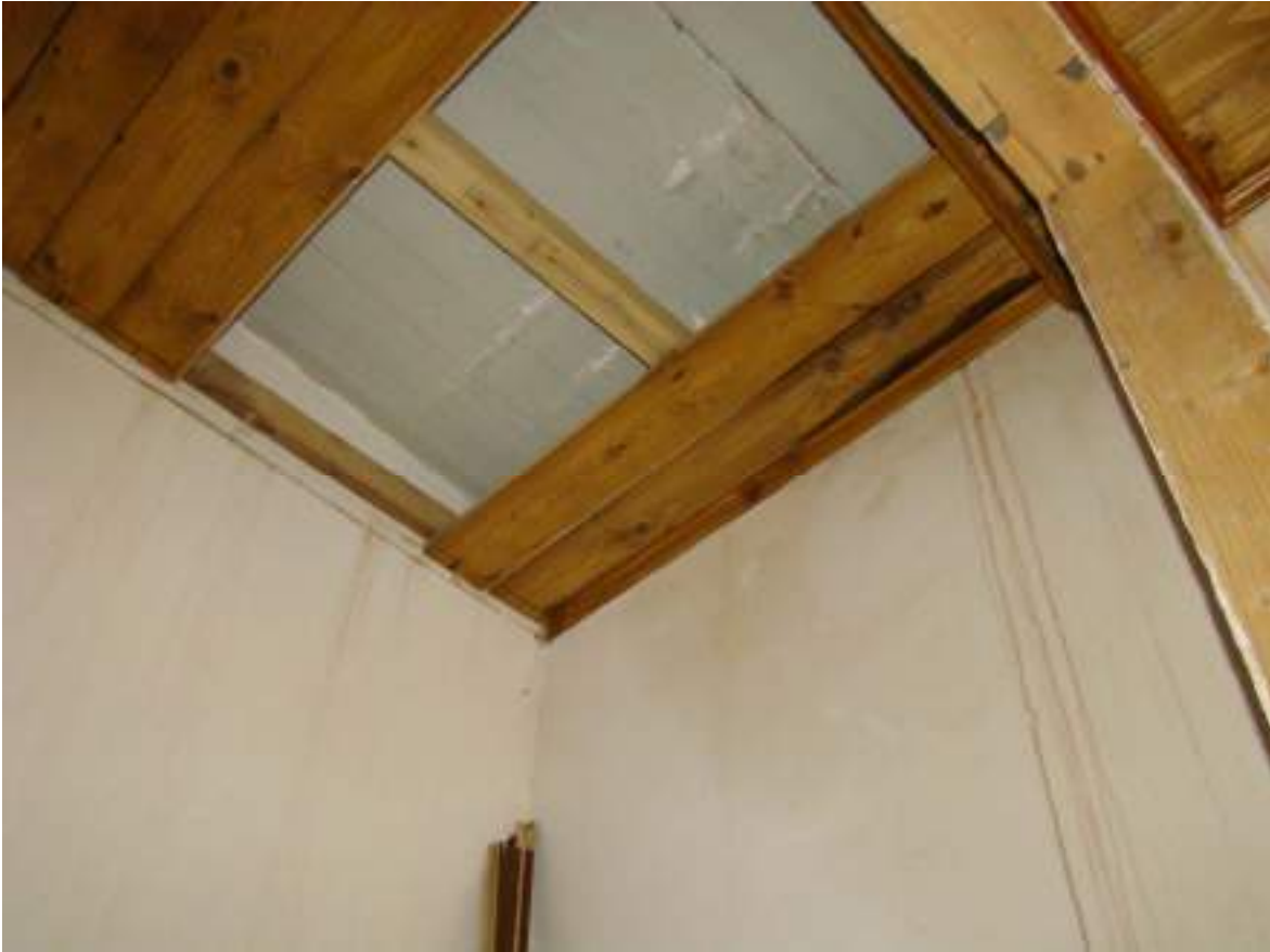
Figura 15 - Infiltrazioni di acqua nel vano ripostiglio
