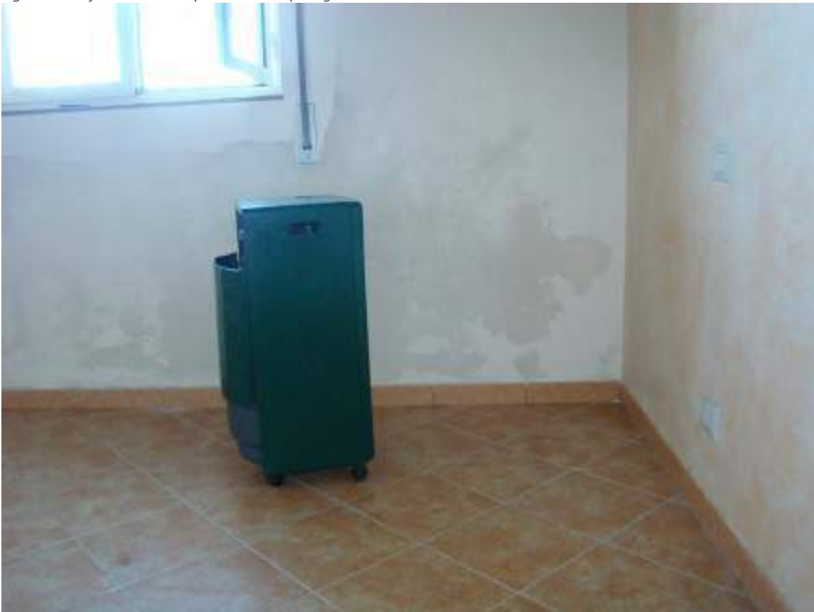
Figura 16 - Umidità per condensa superficiale sulla parete della camera da letto esposta a NORD
