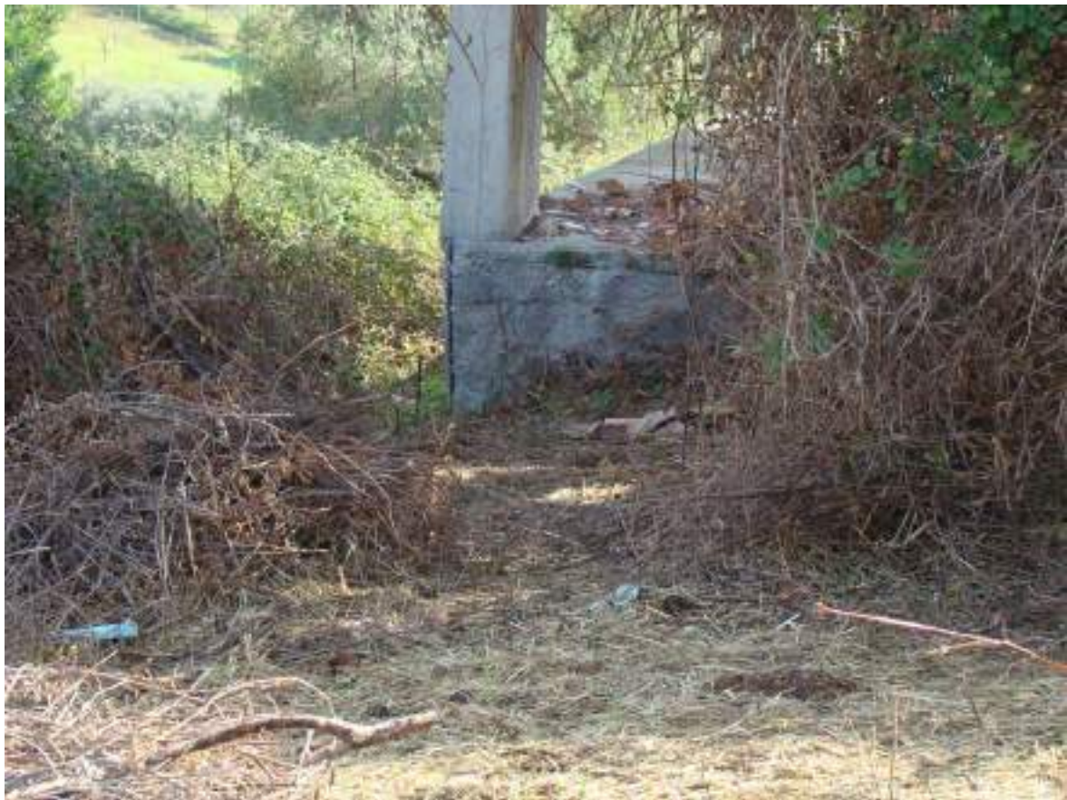
Figura 14 - Fondazioni del fabbricato con armature metalliche esposte
