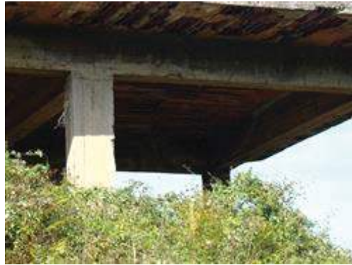
Particolare dello sfondellamento del solaio
