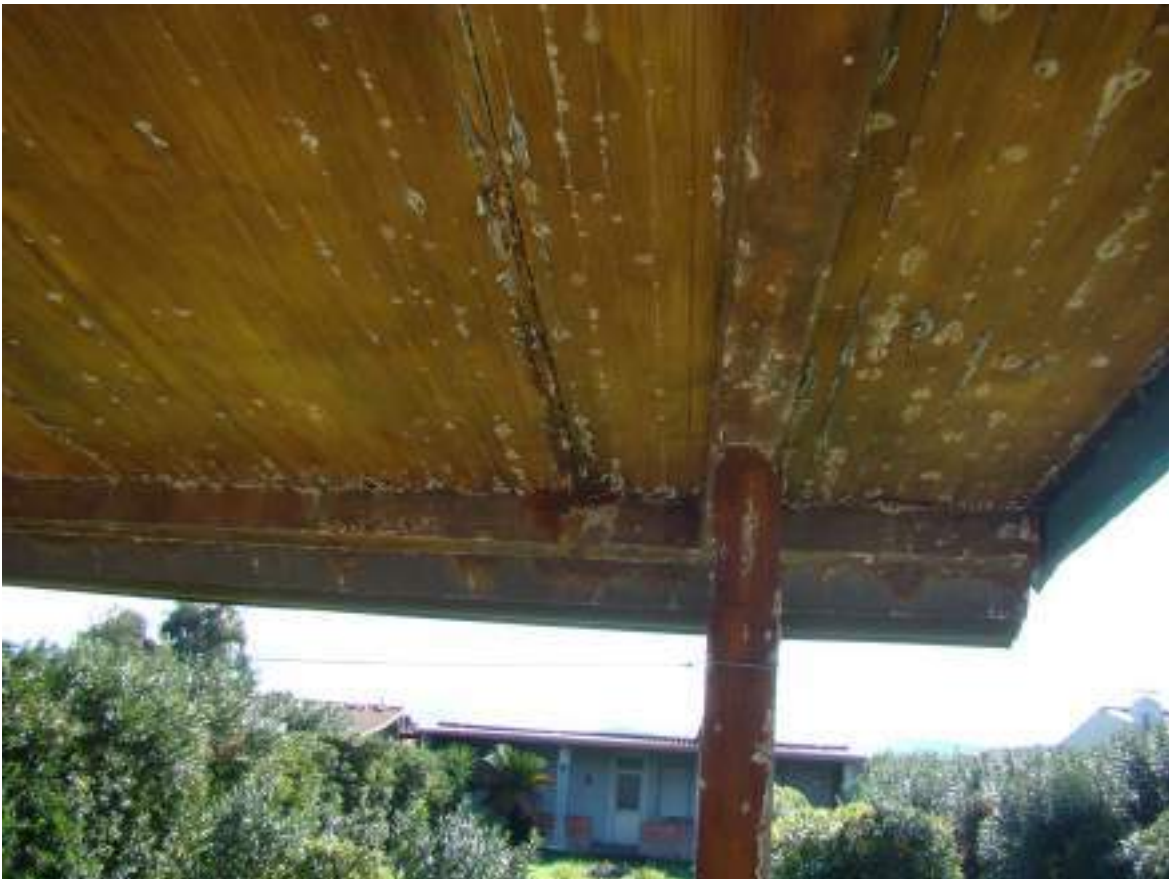
Figura 18 - Ossidazione struttura metallica tettoia esterna
