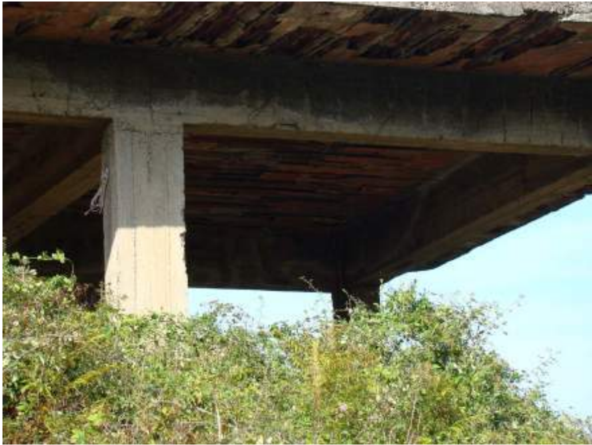
Figura 13 - Solaio sfondellato con armature metalliche esposte
