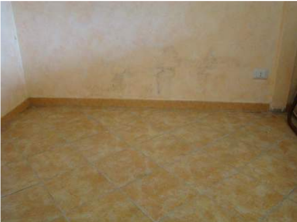
Figura 14 - Umidità per risalita nella parete a confine della camera singola
