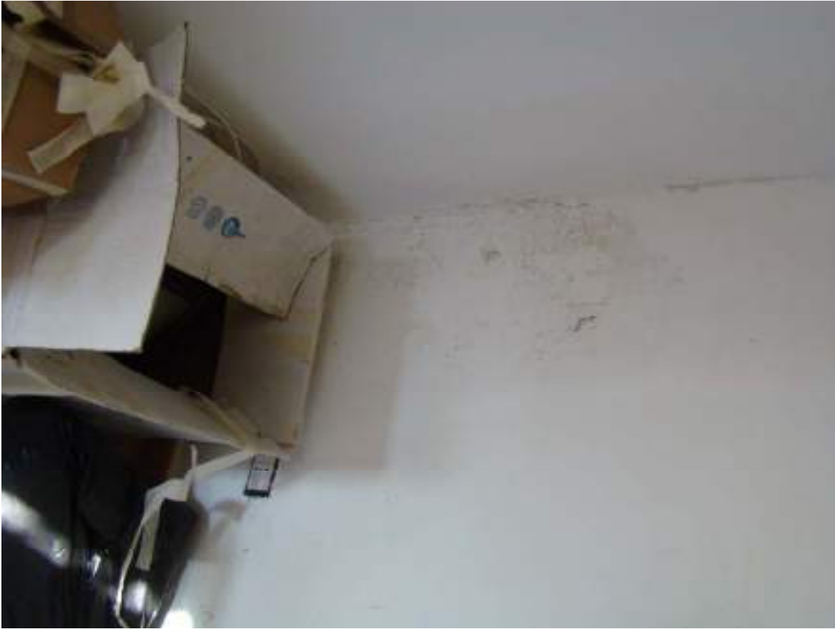
Figura 17 - Umidità per condensa superficiale sulla parete del soggiorno esposta a NORD
