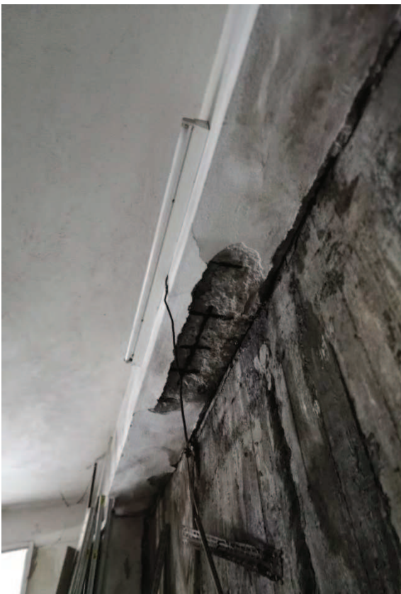
Foto 22- piano cantinato deterioramento muratura
