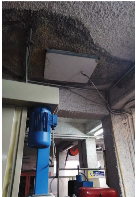
Foto 23- piano cantinato infiltrazioni esterne
