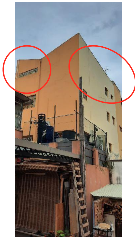
Foto 13: Prospetto retrostante con difformità
